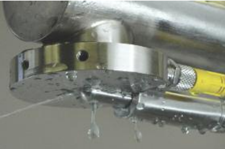
Valve de dosage fermée
